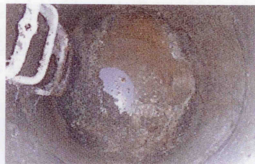
Colmatage du réseau d'assainissement dans la rue Grande
